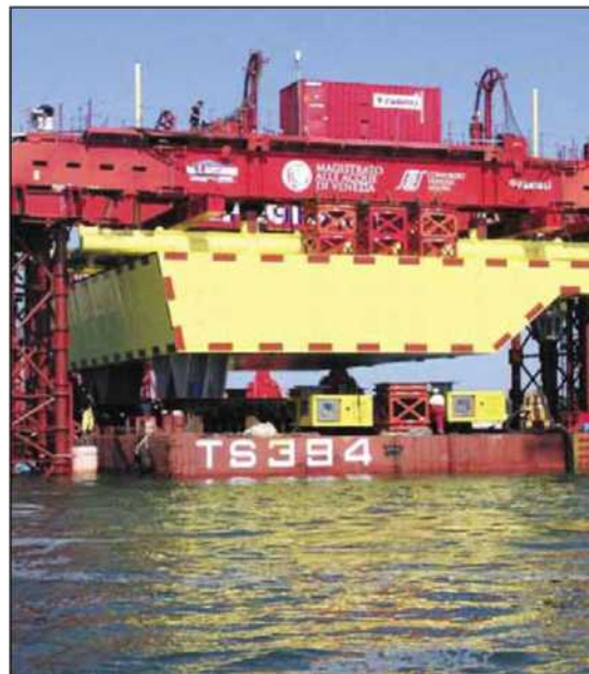
IL GIGANTE DELLA LAGUNA Una paratoia del Mose: oggi il collaudo
