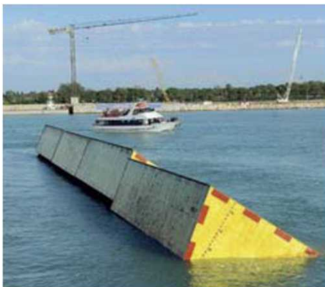
Sotto la lente Sono passati due mesi dal primo test delle paratoie
