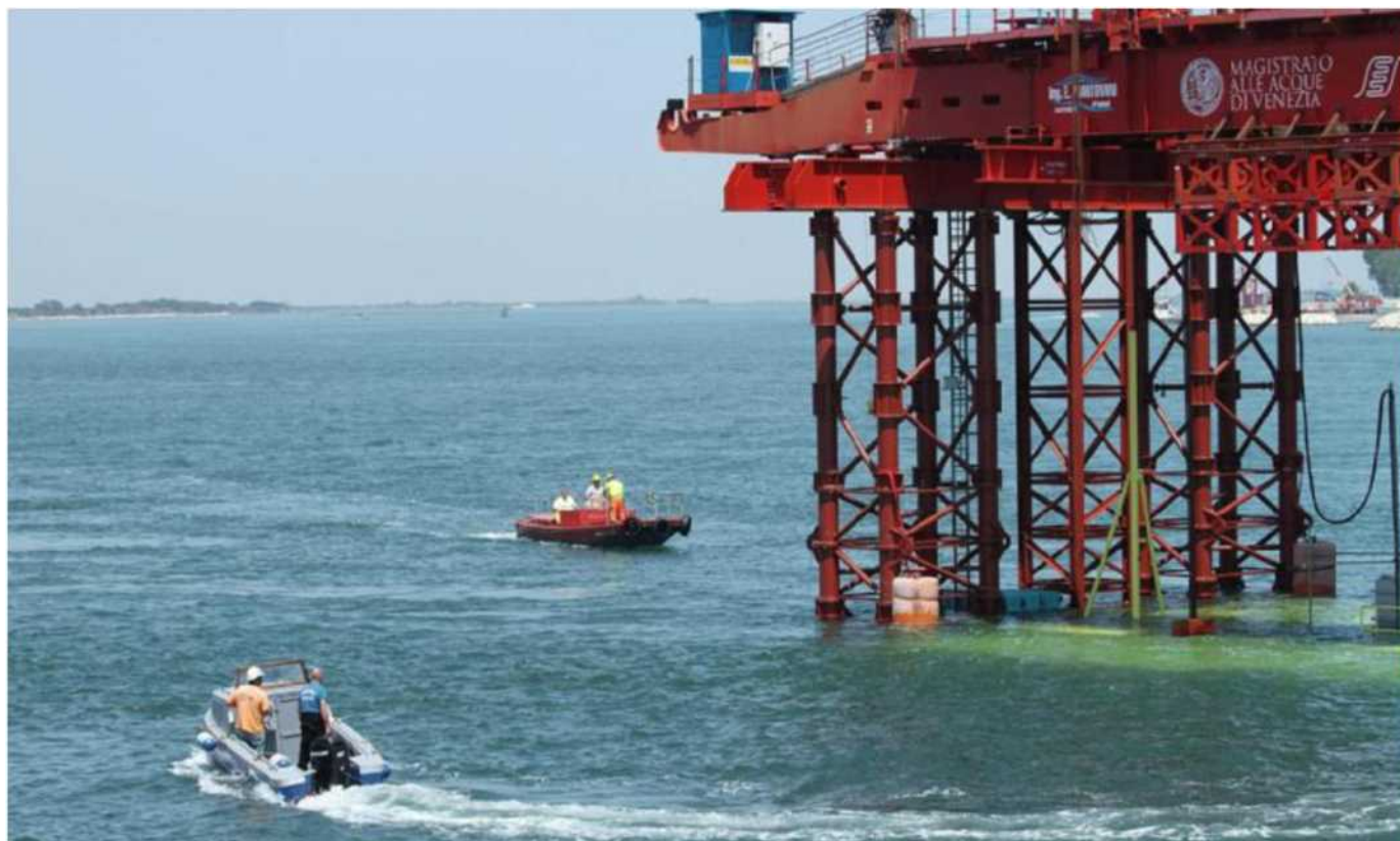
L'installazione di una paratia del Mose alle bocche di porto del Lido, a Venezia
